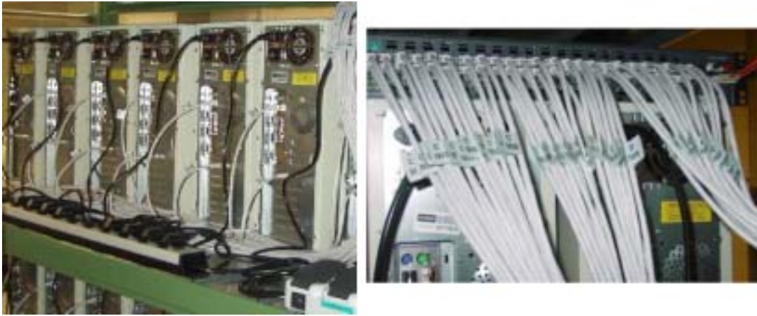
Abbildung 2.4: strukturierte Strom- und Netzwerkverkabelung
